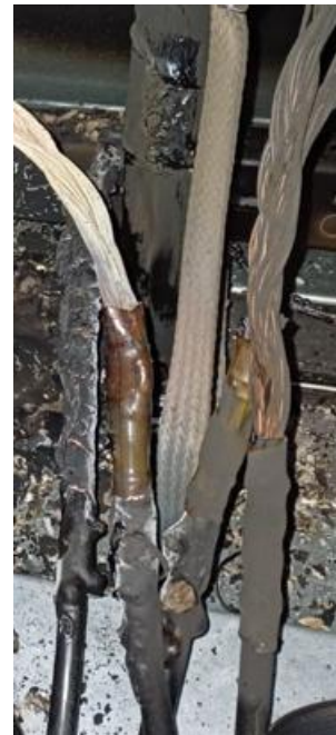
nieprawidłowe połączenie uziemienia
