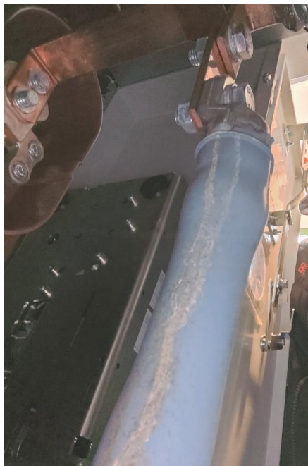
kondensacja powietrza powoduje ściekanie wilgoci
