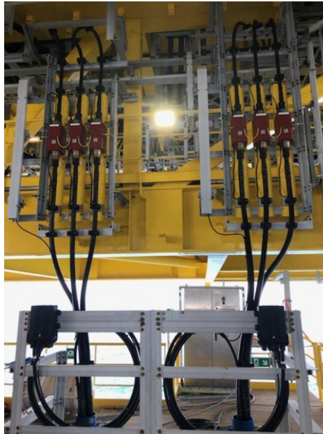
Rys.14 Mufy systemu CONNEX na morskiej stacji transformatorowej
