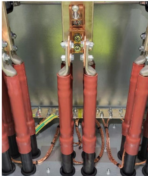
Rys.2 Głowice kablowe polimerowe rozdzielni powietrznej
