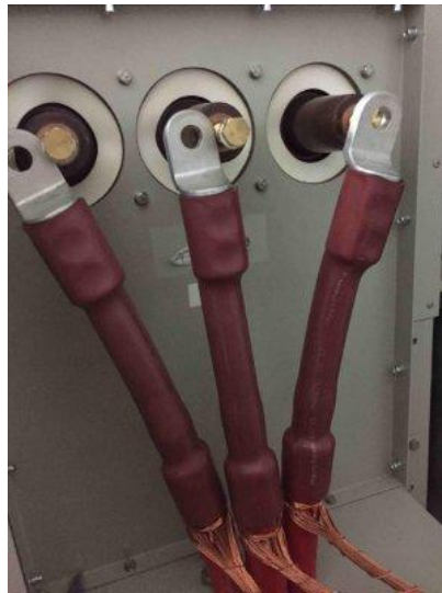
Rys.3 Głowice kablowe polimerowe wpięte na izolatory przepustowe rozdzielni SN
